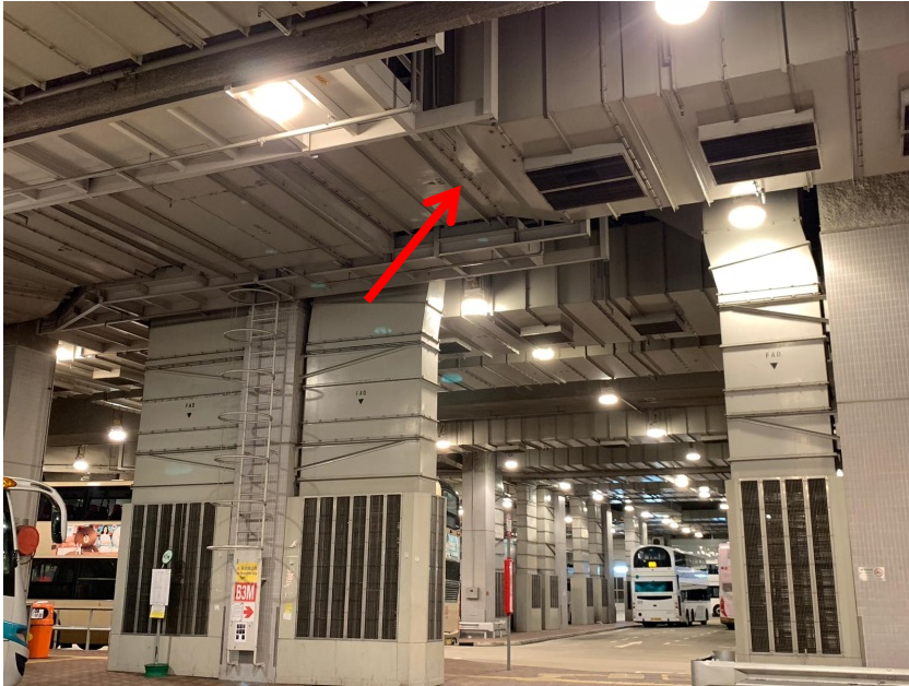
金屬通風管道 (室內) Metal ventilation duct (Internal)
