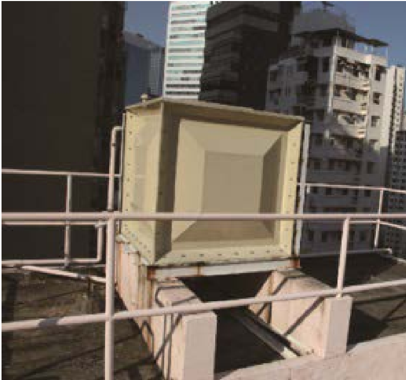
水箱 Water tank
