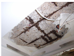
混凝土天花剝落
