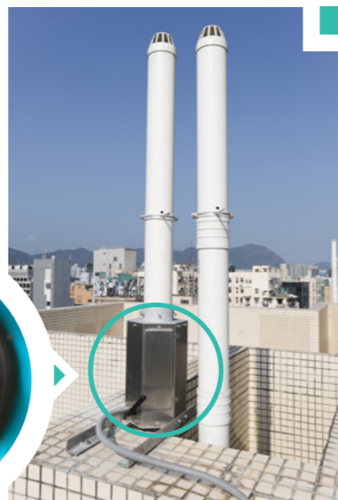
於鼓油街安置大廈的天台通風管上安裝智能通風管淨化器。
