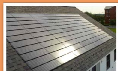
再生能源設施
