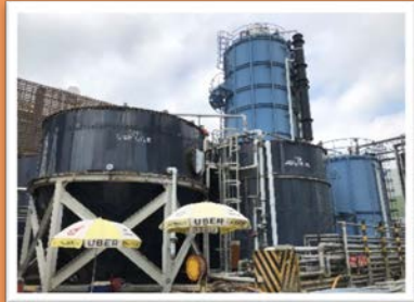
污水處理系統
