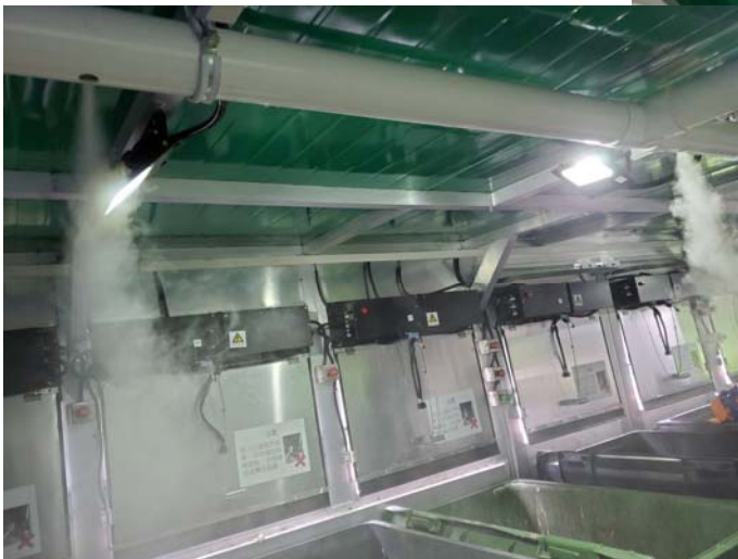
使用臭氧除臭技術以消滅氣味
