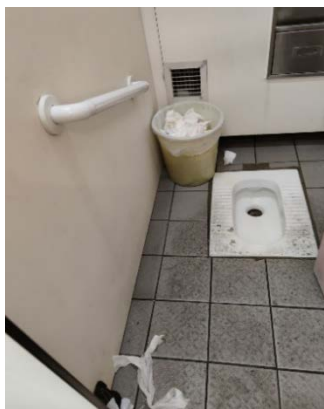
圖 11：廁格地面有垃圾、 垃圾桶裝滿
