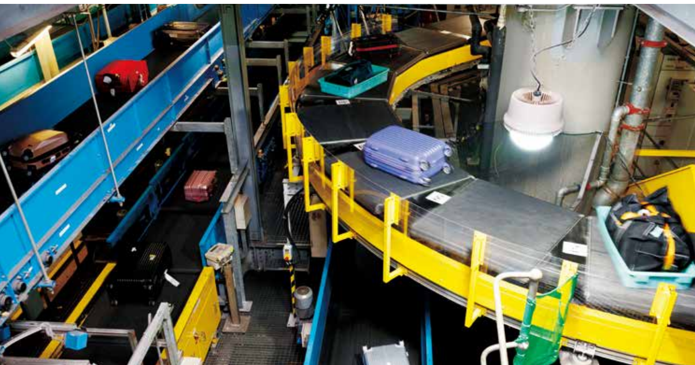
▲ 更新行李處理系統確保設施發揮最佳表現。
