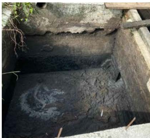
豬場污水處理設施 收集豬糞及廢水
