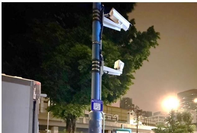
於本港燈柱上安裝的閉路電視 (香港警務處網頁)
